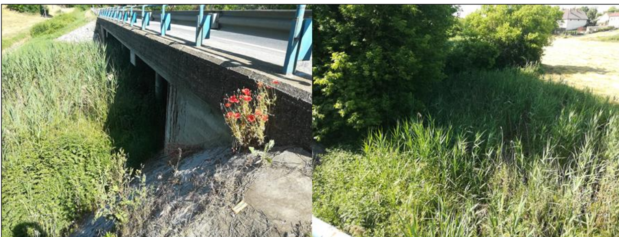
31. ábra A 11+262 km szelvényben lévő 64. főút közúti hidja (A12. műtárgy) alvízi nézete és az alvízi mederszakasz (2023.06.02.)
