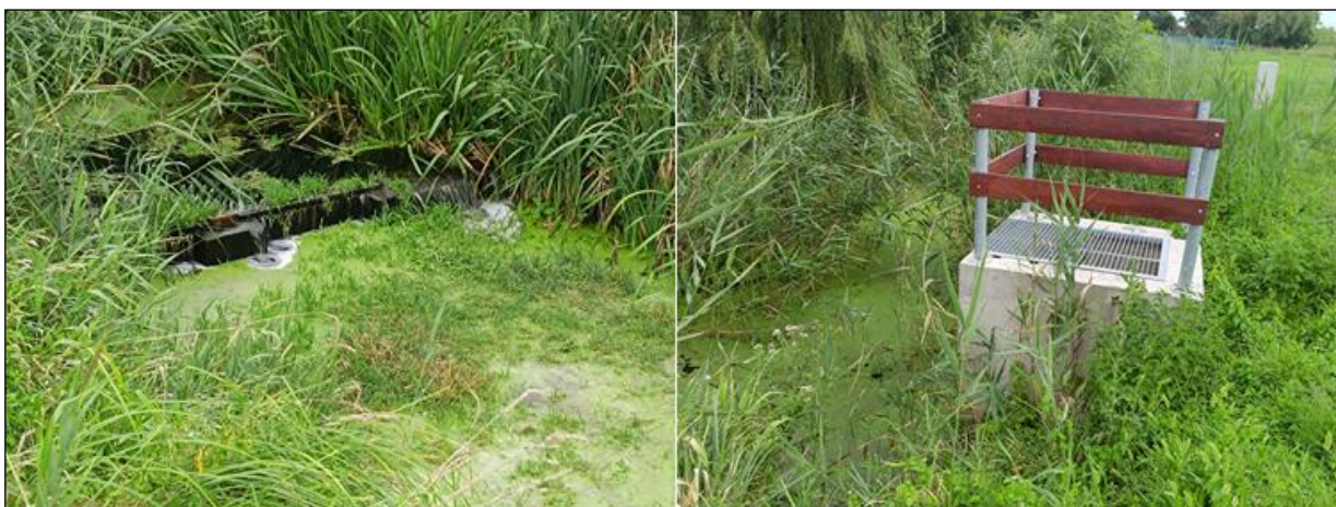
28. ábra A 9+797 km szelvényben lévő duzzasztó műtárgy és az Enyingi-díszítő vízkivételi műtárgya (A9. műtárgy) (2023.07.29.)
