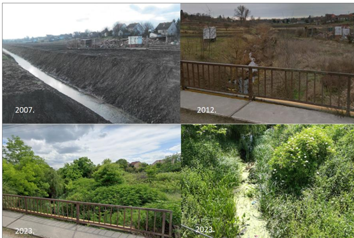
26. ábra A Cinca-Csíkgát-patak Bástya utcai híd alatti szakaszának állapotváltozása (Forrás: Víz Társulat, Google Maps, Saját fotó)
