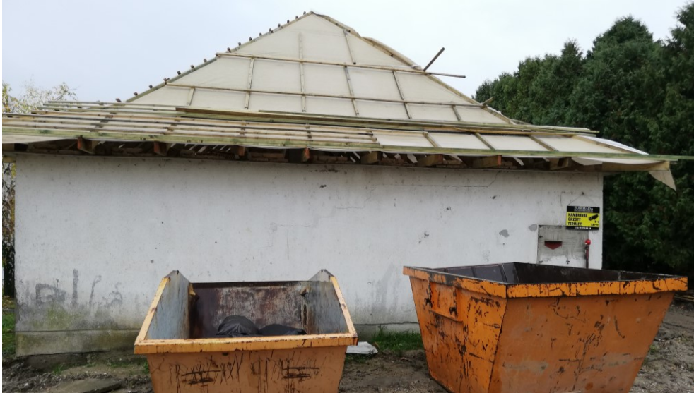
1. kép: Északi fal repedése
